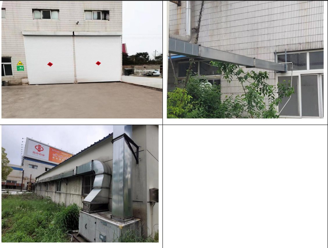
图 2-17 药渣间废气收集、处理措施
